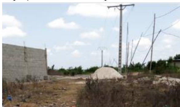
Photo 9 : Aperçu du réseau électrique de la zone du sous projet
