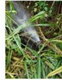
Conduite de captage d'eau endommagée (fuite d'eau)
