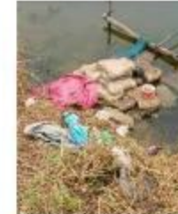
Parés de protection amont dégradés
