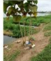
Talus amont dégradé (présence d'arbuste)
