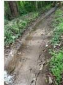
Canal en terre très envahi
