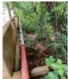
Evacuateur de crue obstrué
