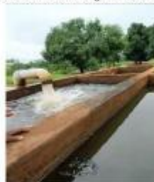
Système de recirculation des eaux provenant du barrage de la Loka
