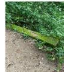
Evacuateur de crue obstrué
