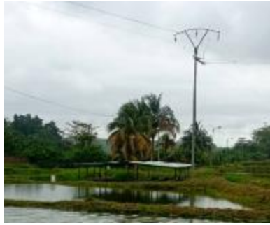
Photo 17 : Ligne basse tension électrique sur le site du sous-projet
